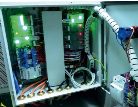
GSC-Hauptschaltkasten/ Main GSC switchbox
