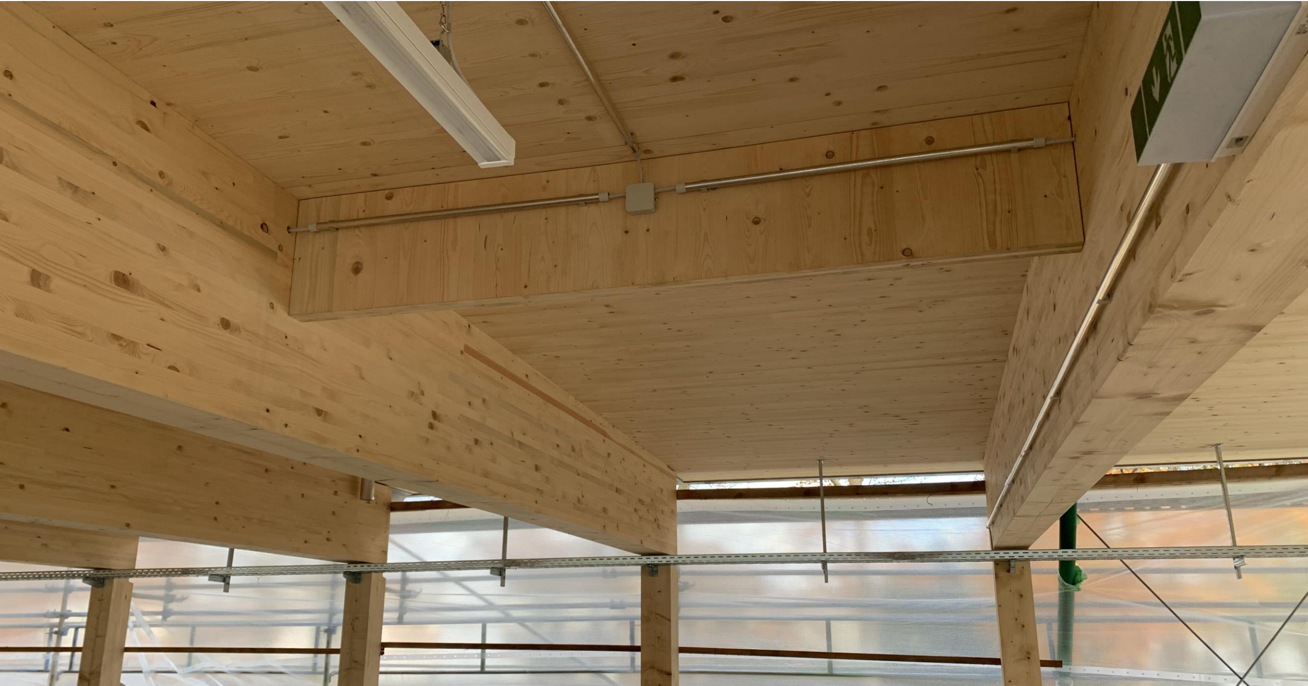
DECKENUNTERSICHT OG - ELEKTROINSTALLATIONEN (BILDRECHT B&O GRUPPE)
